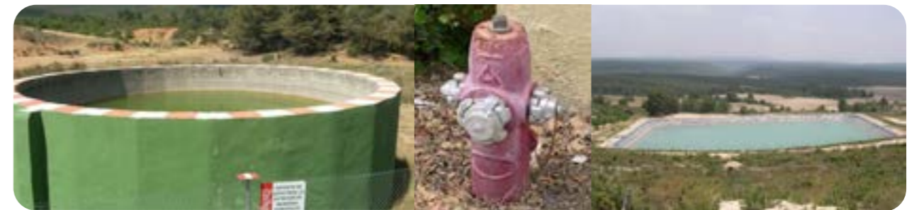
Imatge 189. - Depòsit i hidrant contra incendis, punts d'aigua d'ús específic. Bassa agrícola, ús múltiple. Font: GVA.
