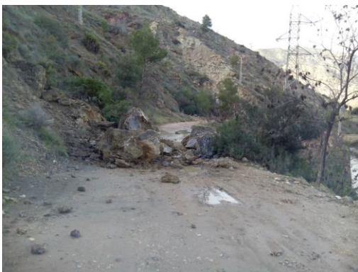
Caída de rocas (Gestalgar)
