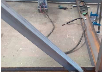
Equipos de soldadura y corte
